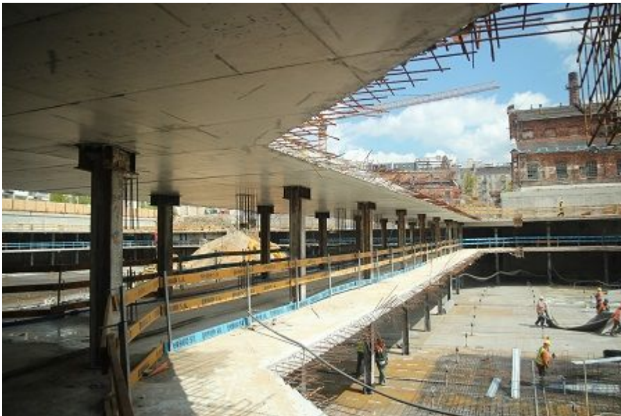
Wykonanie parkingu podziemnego metodą podstropową w Centrum Praskim Koneser, Warszawa. Fot. od Soletanche Polska sp. z o.o. w Warszawie
