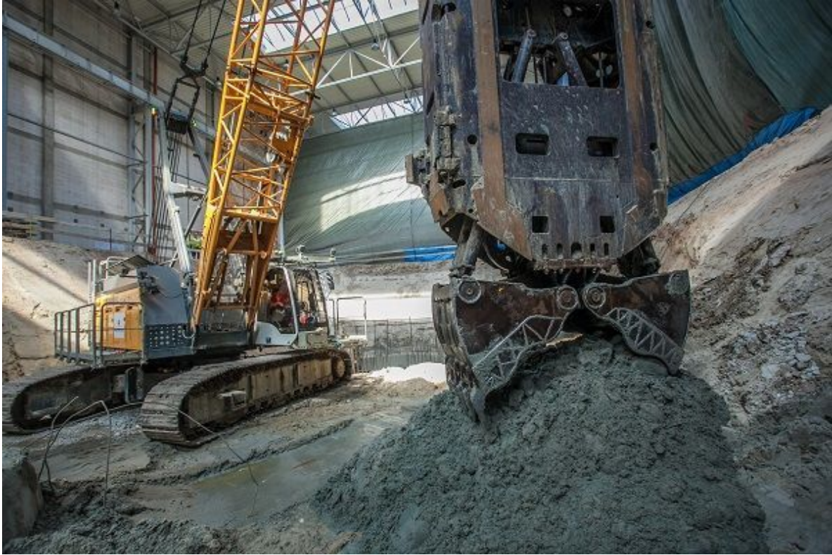
Wykonywanie ścian szczelinowych w szybie technologicznym. Fot. od firmy Soletanche Polska sp. z o.o. w Warszawie
