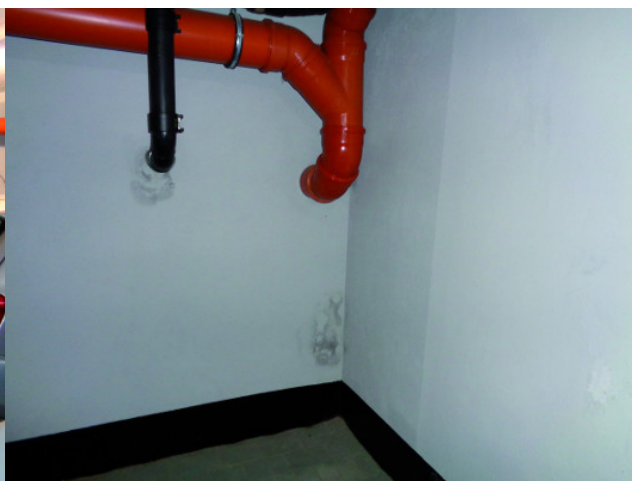
Fot. 2. Przecieki punktowe na skutek nieprawidłowego zabezpieczenia miejsc przebieg instalacyjnych (fot. archiwum autorów)
