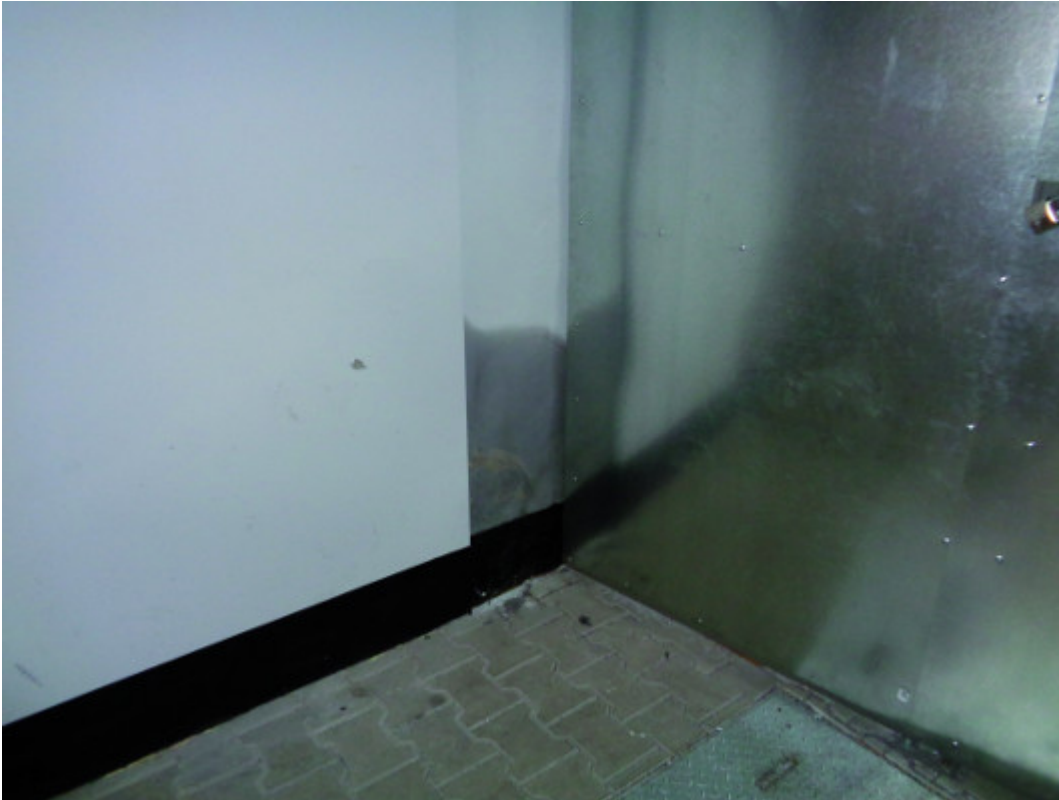
Fot. 3. Zawilgocenia wynikające z braku ciągłości izolacji w węźle konstrukcyjnym (fot. archiwum autorów)
