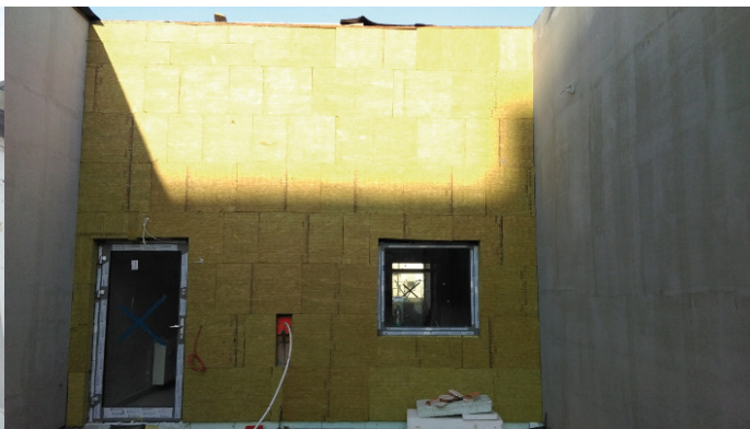
Fot. 2. Brak zabezpieczenia warstwy termoizolacyjnej przed oddziaływaniem warunków atmosferycznych
