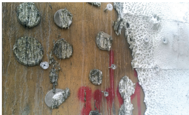
Fot. 3. Nieprawidłowe klejenie styropianu uszkodzonego wskutek pożaru
