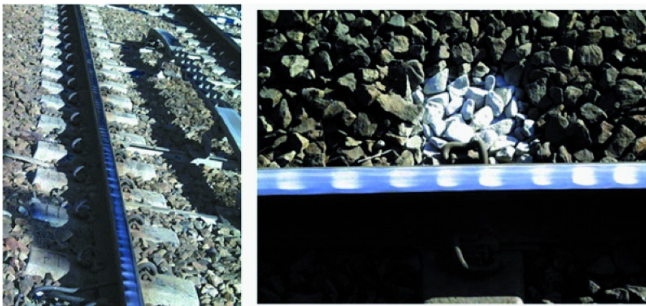
Fot. 3. Widok zużycia falistego na powierzchni tocznej główki szyny – jaśniejsze powierzchnie odpowiadają strefie wierzchołków fali [7]
