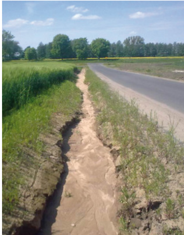
Fot. 4. Uszkodzenia dna rowu przez opady
