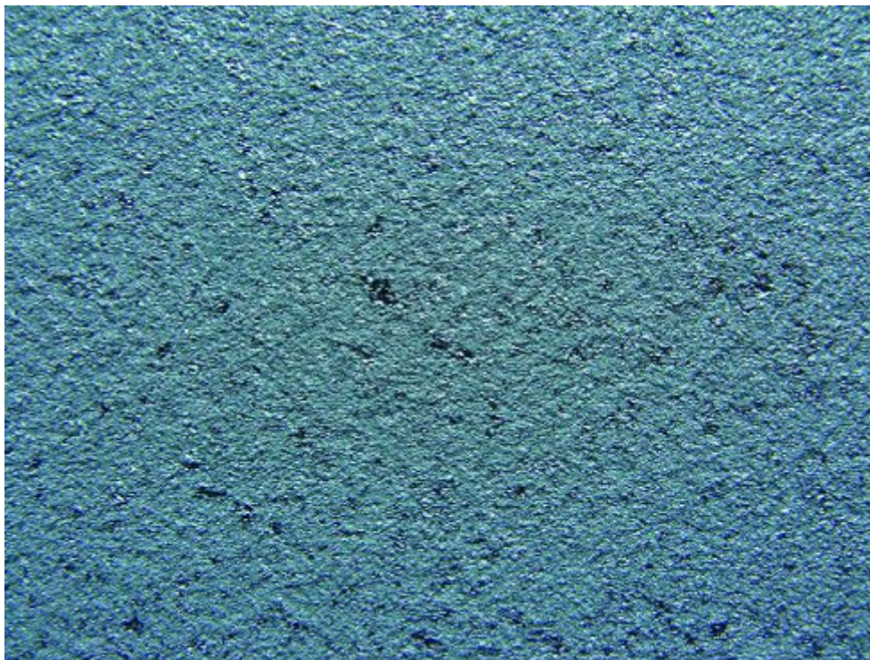
Fot. 5. Nierówna powłoka metalizacyjna
