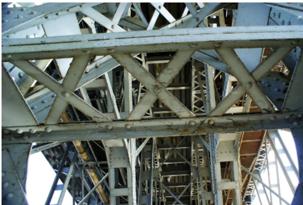
Fot. 2. Trudna od zabezpieczenia antykorozyjnego konstrukcja mostu kratowego
