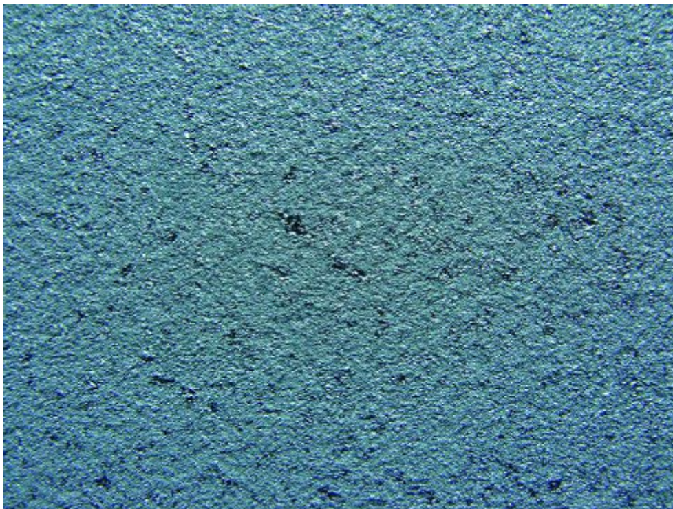
Fot. 5. Nierówna powłoka metalizacyjna
