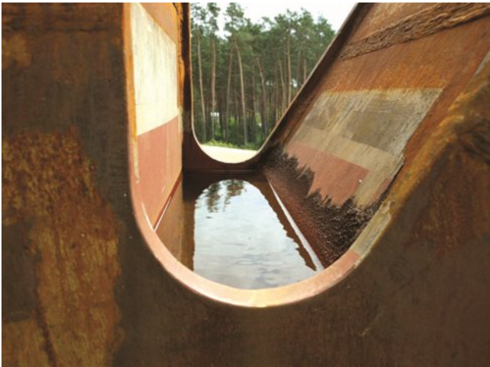
Fot. 4. Niewłaściwe rozwiązanie konstrukcyjne pozwalające na gromadzenie się wody na moście kolejowym
