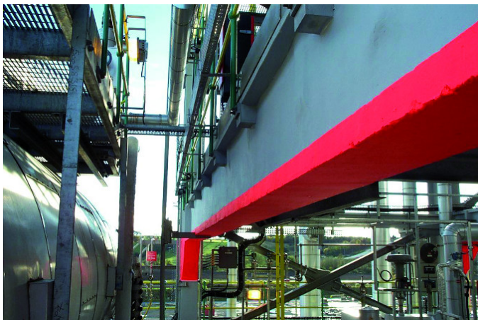
Fot. 4. Zabezpieczenie konstrukcji masą natryskową o odporności ogniowej określonej krzywą węglowodorową. Autor: archiwum ITB
