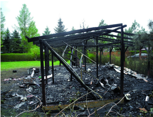
Fot. 1. Opalona drewniana konstrukcja nośna domu letniskowego po pożarze. Autor: archiwum ITB
