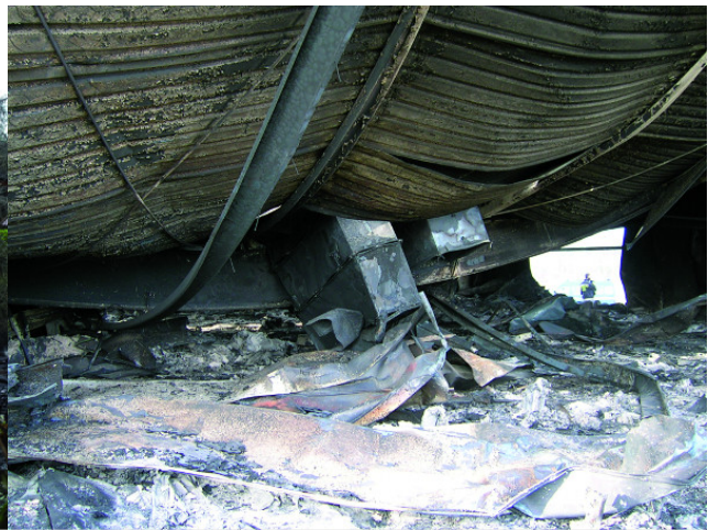
Fot. 2. Zniszczona w trakcie pożaru, niezabezpieczona ogniochronnie stalowa konstrukcja nośna. Autor: archiwum ITB
