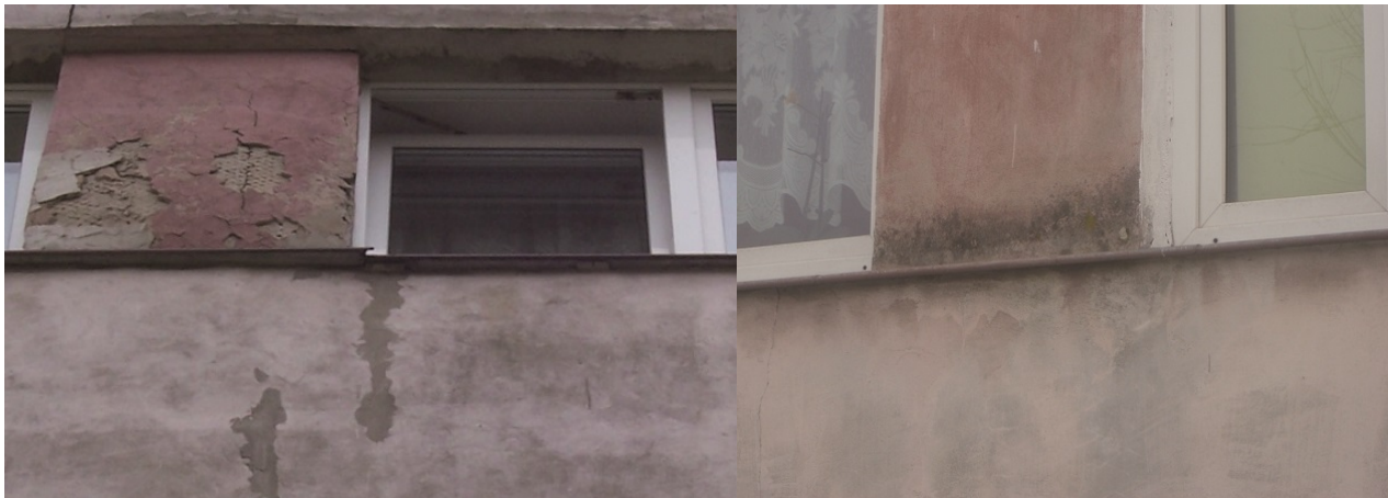
Fot. 3. Rysy i ubytki w warstwie tynku zewnętrznego
