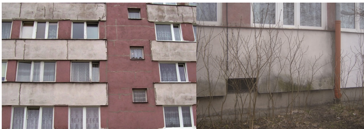
Fot. 1. Rysy na powierzchni tynku zewnętrznego
