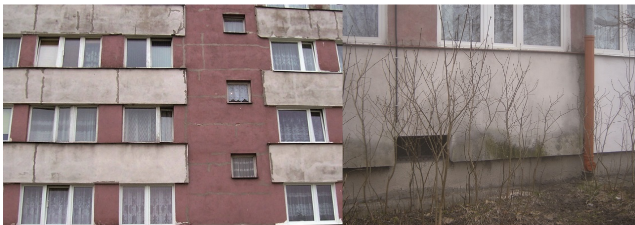
Fot. 1. Rysy na powierzchni tynku zewnętrznego
