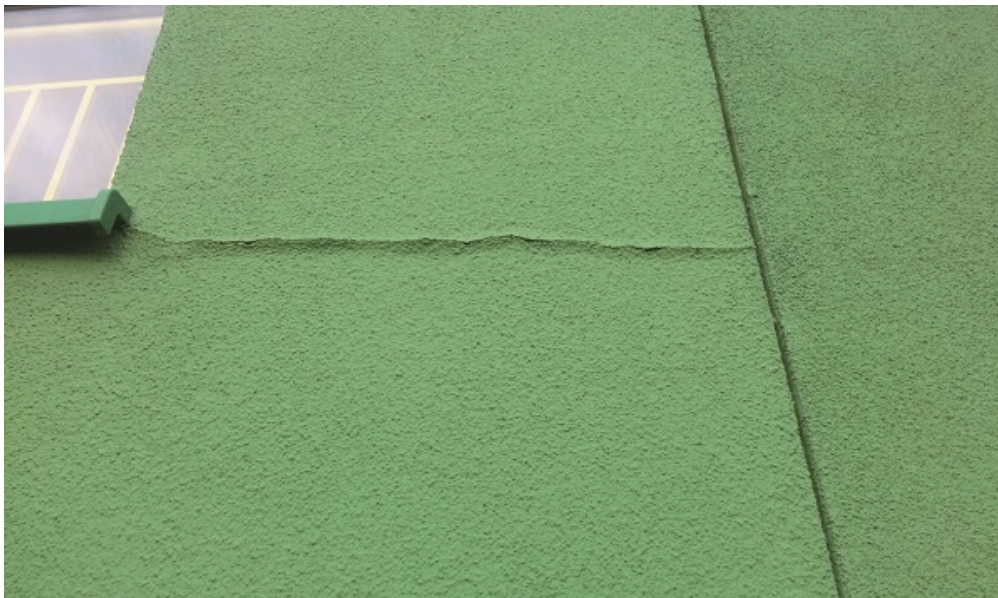
Fot. 4. Rysy na ścianie
