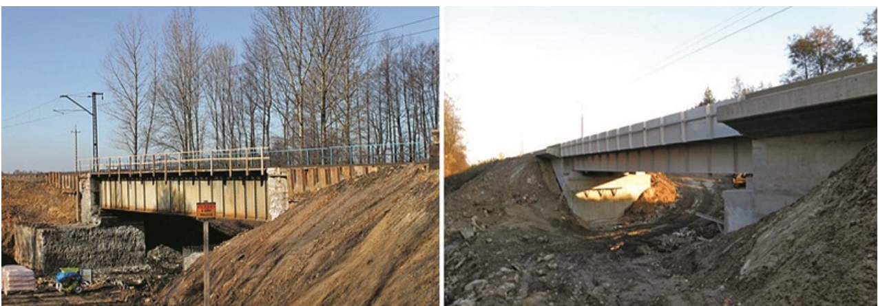
Fot. 5. Wiadukt kolejowy przed i po modernizacji, obejmującej całkowitą wymianę konstrukcji stalowej przęsła
