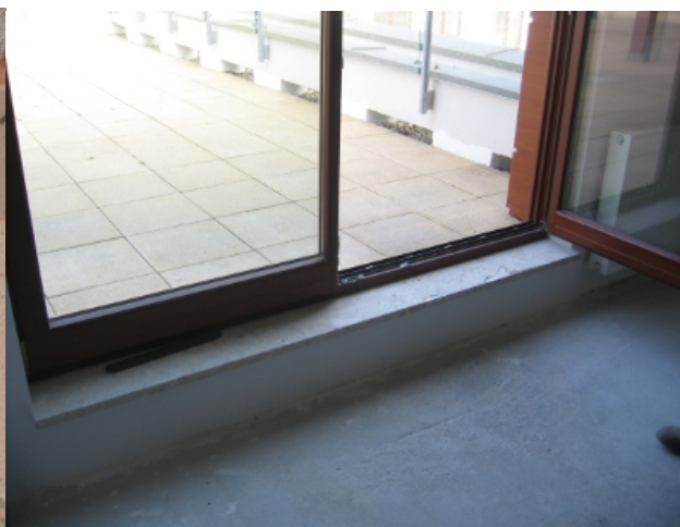
Fot. 2. Poziom nawierzchni tarasu przewyższający poziom posadzki w mieszkaniu uniemożliwia prawidłowe zakończenie warstwy hydroizolacyjnej przy drzwiach
