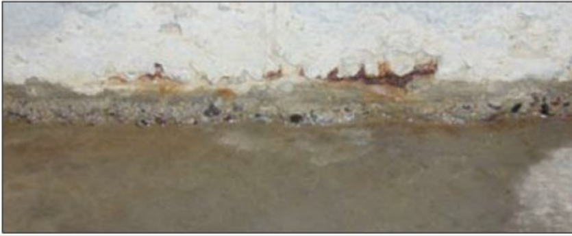
Fot. 4. Porowata dolna część ściany przepuszcza wodę
