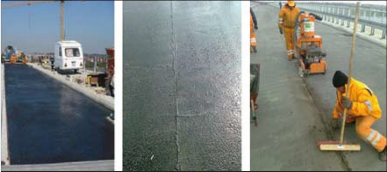
Fot. 4. Problemy występujące na obiekcie z mostowym o płycie betonowej z zastosowaniem asfaltu lanego [1]
