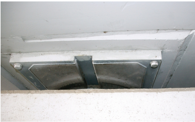
Fot. 2. Widok kanału przewodnicy w łożysku jednokierunkowo przesuwym
