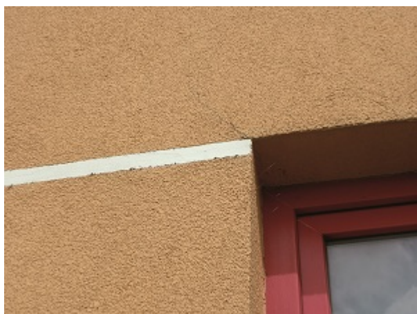
Pęknięcie tynku w narożniku otworu okiennego, przy którym nie wykonano dodatkowego diagonalnego zbrojenia siatką
