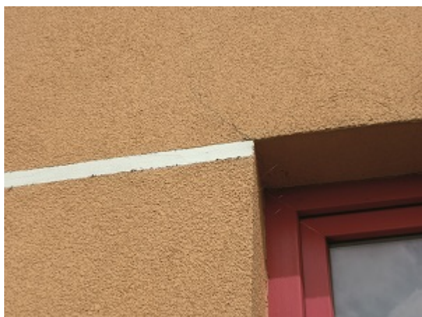
Pęknięcie tynku w narożniku otworu okiennego, przy którym nie wykonano dodatkowego diagonalnego zbrojenia siatką
