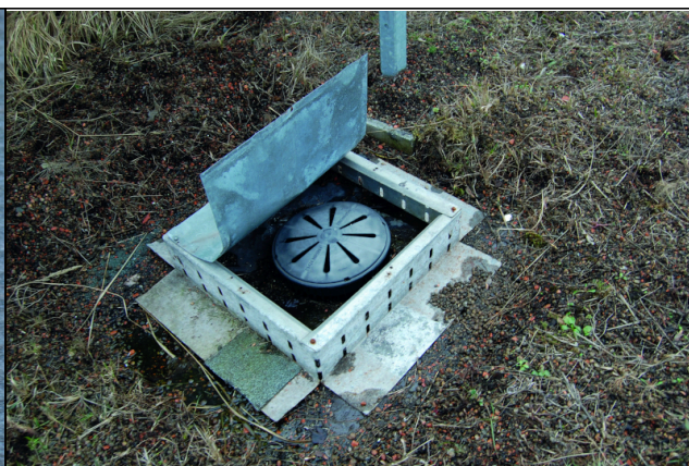
Fot. 5. Skrzynka kontrolna z ulegającej korozji blachy ocynkowanej, z pokrywą bez możliwości wielokrotnego otwierania i zamykania (fot. autora)
