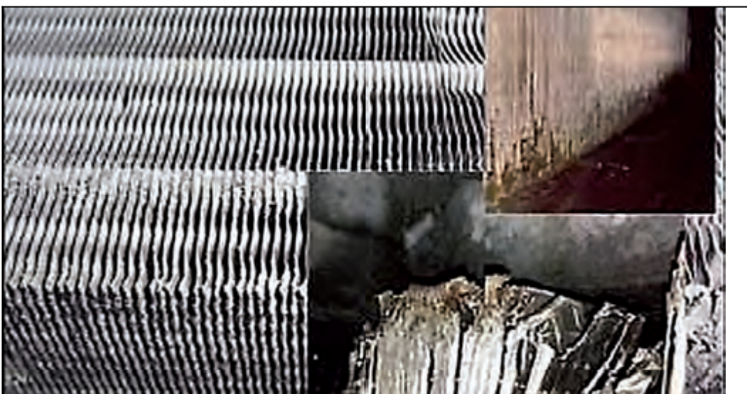
Fot. 1. Skutki działania korozji na elementy instalacji wentylacyjnej basenowej: nagrzewnica i parownik [7]
