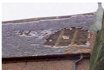
Fot. 1. Stary dach pokryty dachówką karpiówką (jedną z cięższych pokryć) został uszkodzony przez silny wiatr wiejący skośnie od strony szczytu z attyka. Dachówki poderwały siły ssące, które są najsilniejsze tuż za przeszkodami (attyka i kalenica).
