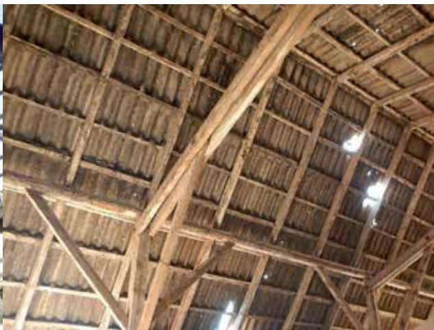
Fot. 8. W dachach otwartych zmienne ciśnienie powietrza wewnętrznego w czasie wichury powoduje obluźnianie mocowań i ich wyłamanie. Na tym dachu silny wiatr wyrwał fragmenty falistych płyt azbestowych w miejscach ich mocowania.
