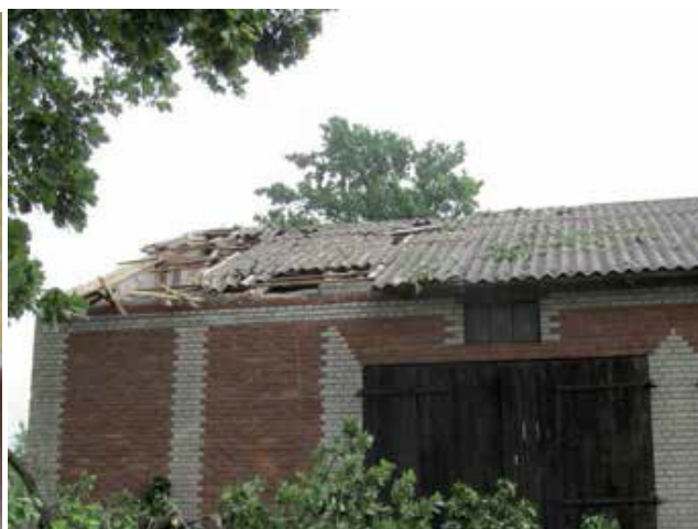
Fot. 6. Ten dach ma uszkodzenia bardzo charakterystyczne dla oddziaływań silnych wiatrów wiejących w kierunku równoległym do kalenicy. Przy takim ustawieniu budynku największe siły ssące występują nad ścianą szczytową - od strony nawietrznej.
