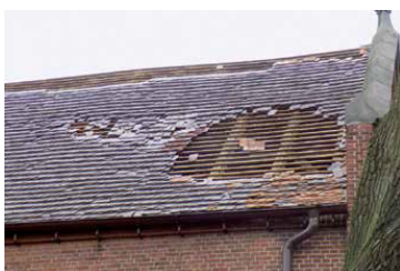
Fot. 1. Stary dach pokryty dachówką karpiówką (jedną z cięższych pokryć) został uszkodzony przez silny wiatr wiejący skośnie od strony szczytu z attyka. Dachówki poderwały siły ssące, które są najsilniejsze tuż za przeszkodami (attyka i kalenica).
