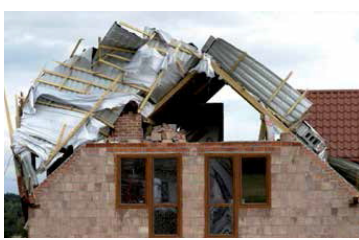
Fot. 2. Blachodachówka została poderwana na krawędzi szczytowej dachu. Dalsze uszkodzenia powstały z powodu zerwania połączenia między łatami i kontrłatami lub kontrłatami i więźbą. Dowodzi to zastosowania zbyt słabych gwoździ. Farmery natomiast utrzymały łaty.
