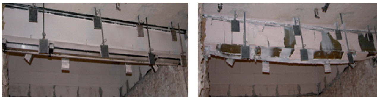
Fot. 4. Pas międzykondygnacyjny, częściowa konfiguracja, krzywa standardowa N: a) strona od wewnątrz przed badaniem, b) strona od wewnątrz po badaniu
